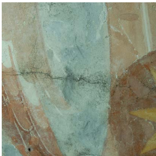
Detalj av spricka i tunnvalvets cirkel nr 11.
